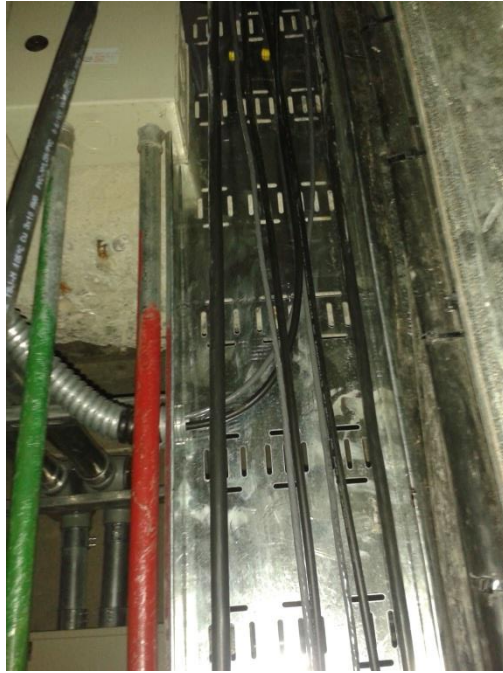
Figura 21: Fibra óptica Cableado Vertical Elaborado por: Investigadoras
