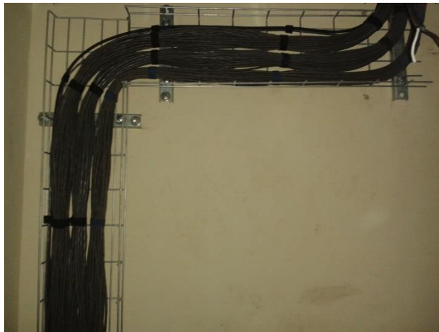
Figura 22: Enlace de Fibra óptica Rack de Piso Elaborado por: Investigadoras
