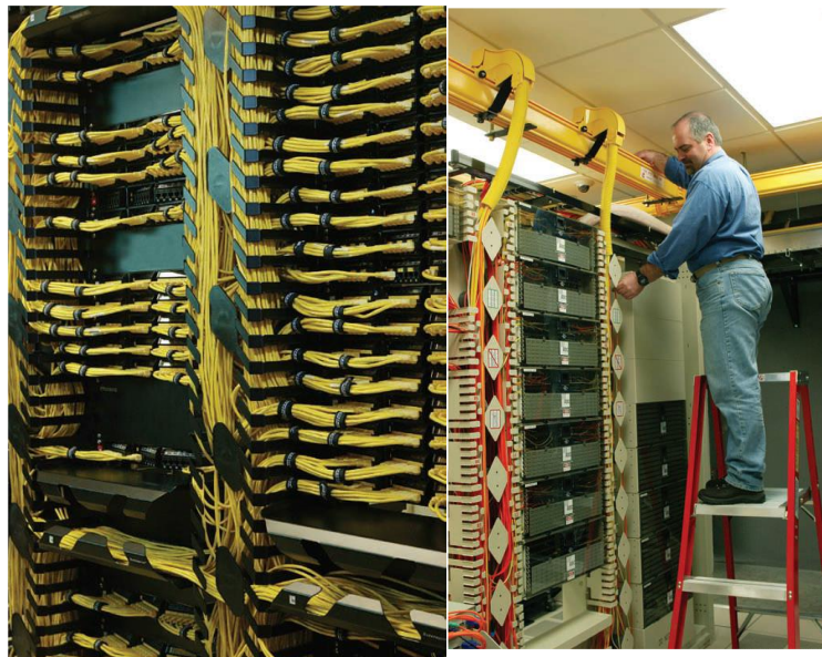
Figura 36: Tendido de Cables Data Center Elaborado por: (Tecnico ADC Informe [Imagen])
