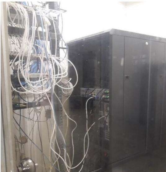
Figura 11 Cuarto de Servidores
