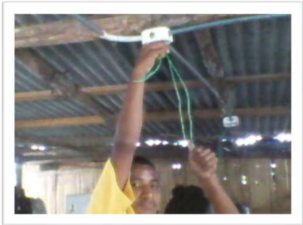
Moradores involucrados en el trabajo de grado instalaciones eléctricas interiores en viviendas populares
