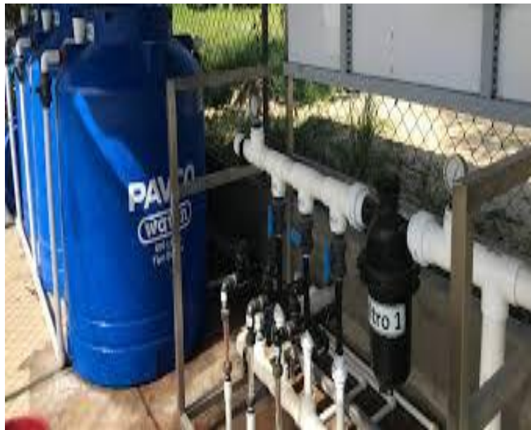
Anexo 1. Bombas mecánicas para la distribución de las soluciones solubles.
