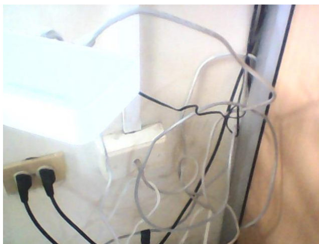
Figura # 4 Red Ethernet Cableada de la Facultad de Ciencias de la Salud
