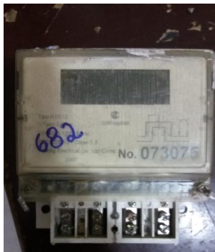
Anexo 2. (Medidor electrónico monofásico con lectura digital)
