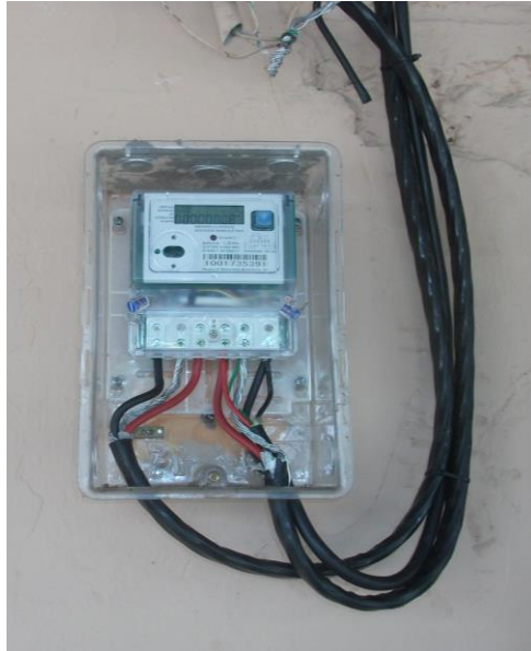
Anexo 4. (Medidores electrónicos digital bifásicos de lectura digital con batería interna)
