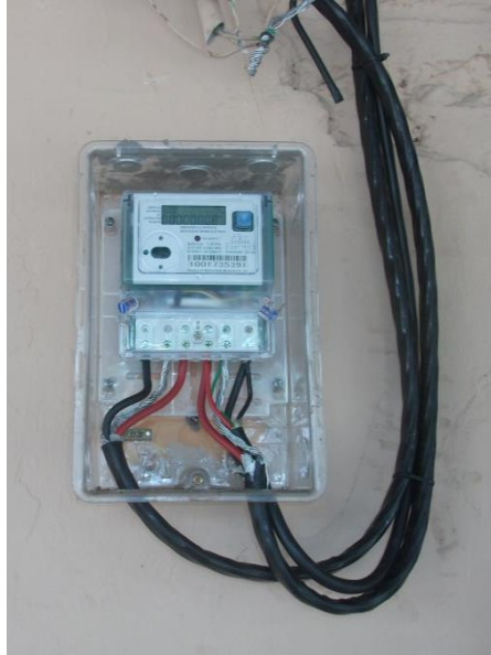
Fig. 1 (Medidor Bifásico con display digital Marca Hangzhou)
