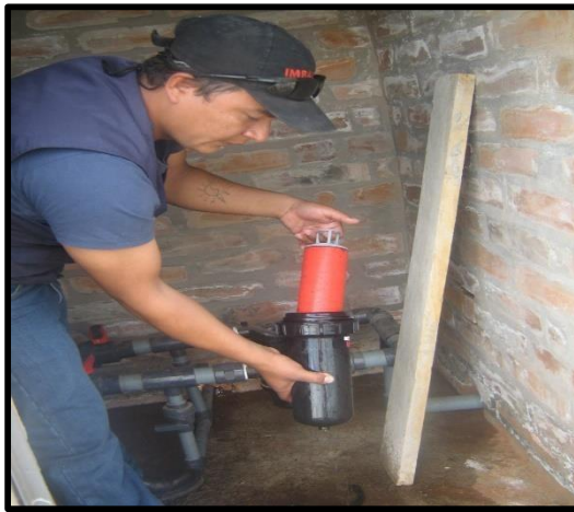
Fig. 3. Instalación de filtrado
