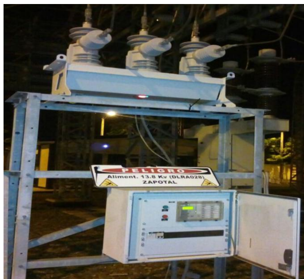
Figura 2. Reconectador Alim. Zapotal. S/E Ventanas. Fuente: Cnel. EP.
