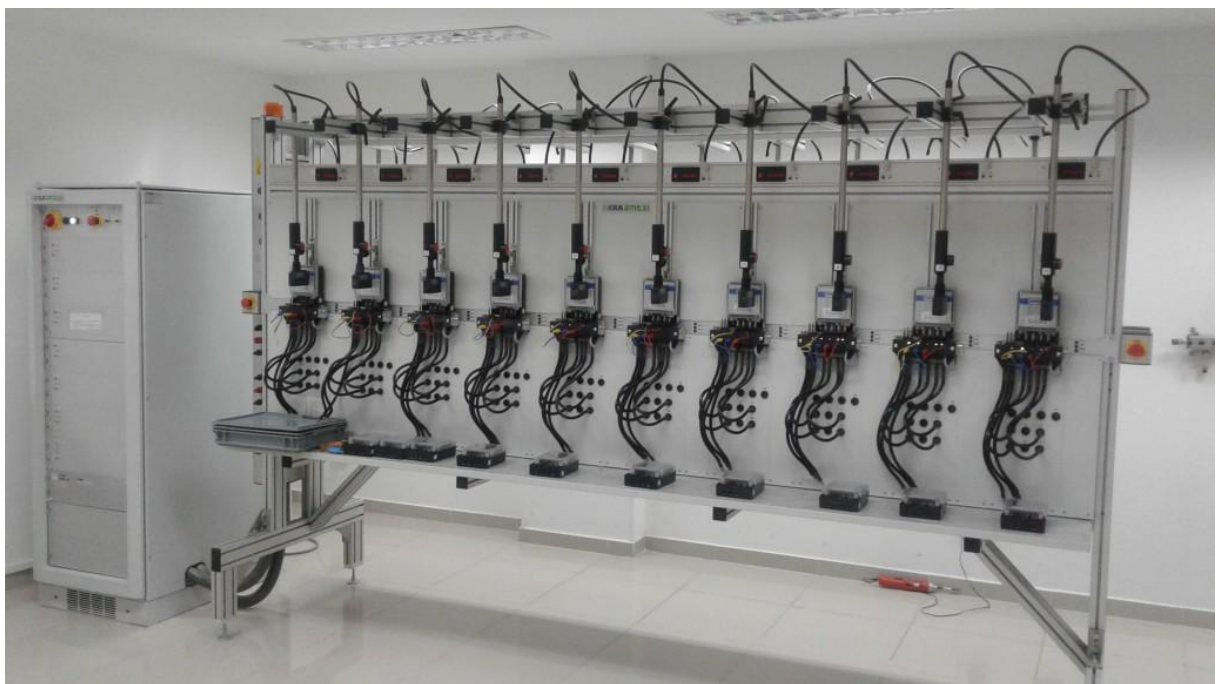
Figura 5 (contrastación de medidores)
