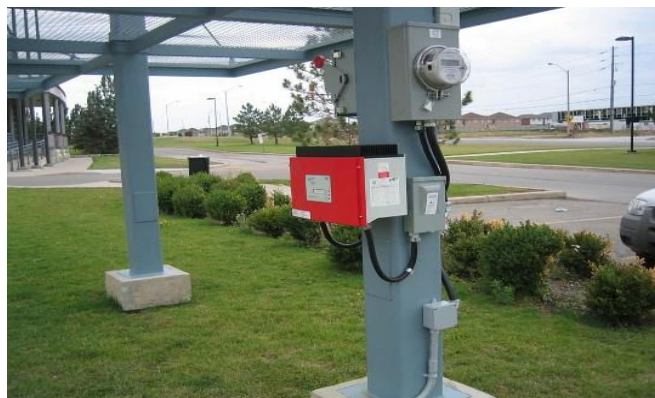
Imagen 1 Medidor Eléctrico - (Electrica, 2007).
