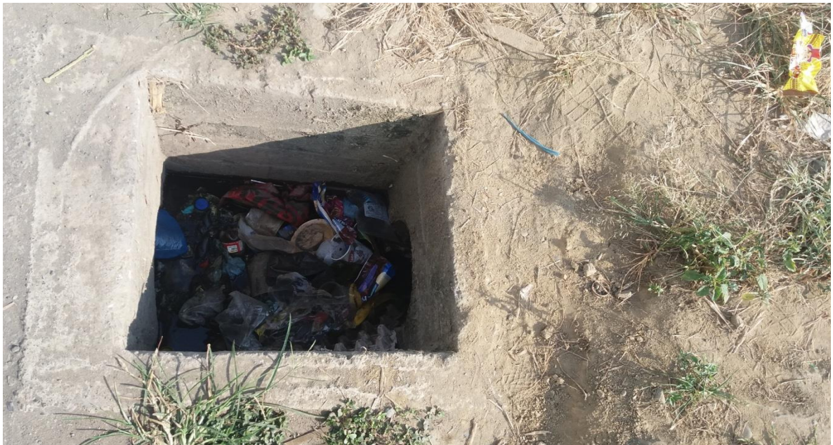
Pozo de alcantarilla descubierta y llena de desechos putrefactos
