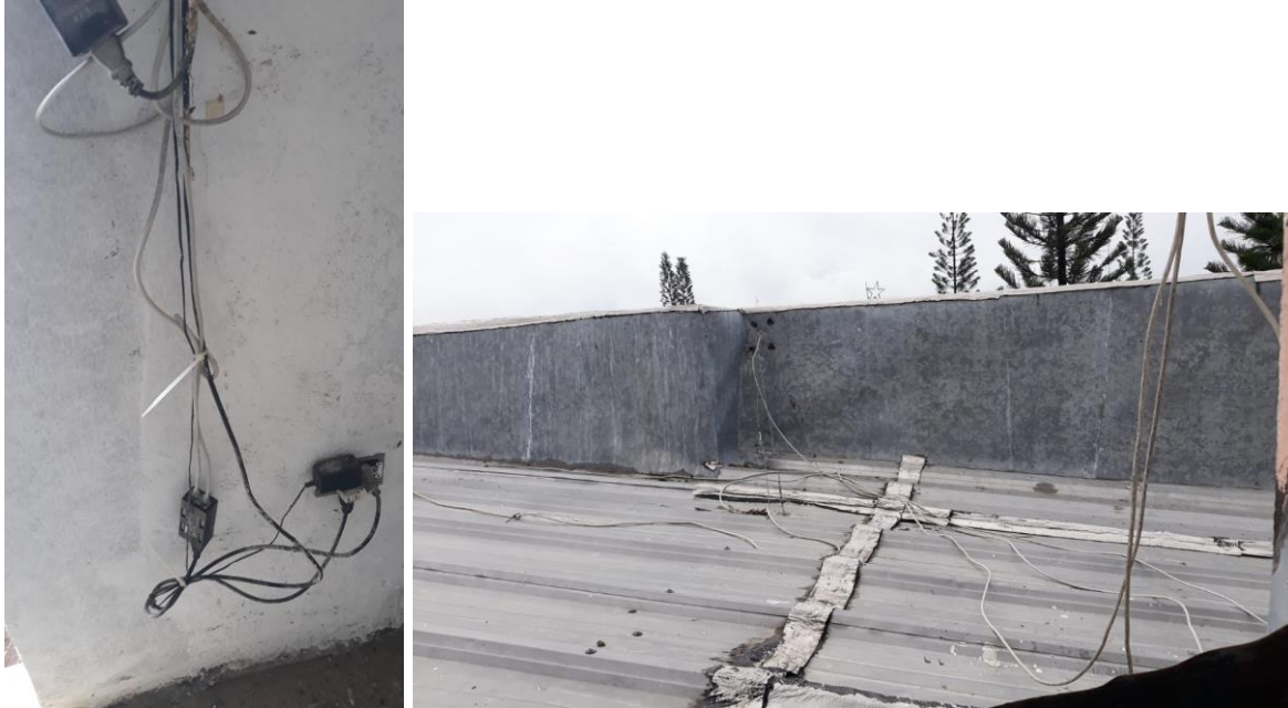
Foto 2: Red conexión biométrico Gad Baba y cableado sobre un techo Tomada por. Jhonn Zurita
