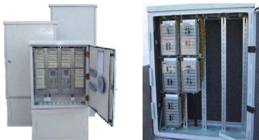
Figura 3. Armarios de red secundaria Fuente: Normas de construcción de planta externa. CNT. 2012
