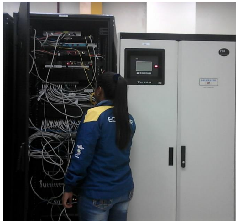
Imagen 6. Cableado del Data Center
