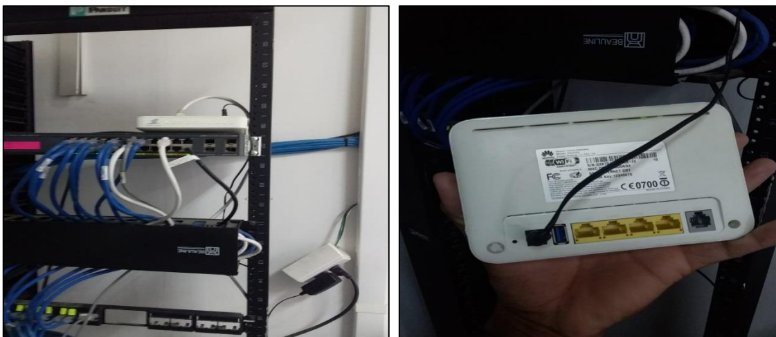
Foto N°4: Servidor y router
