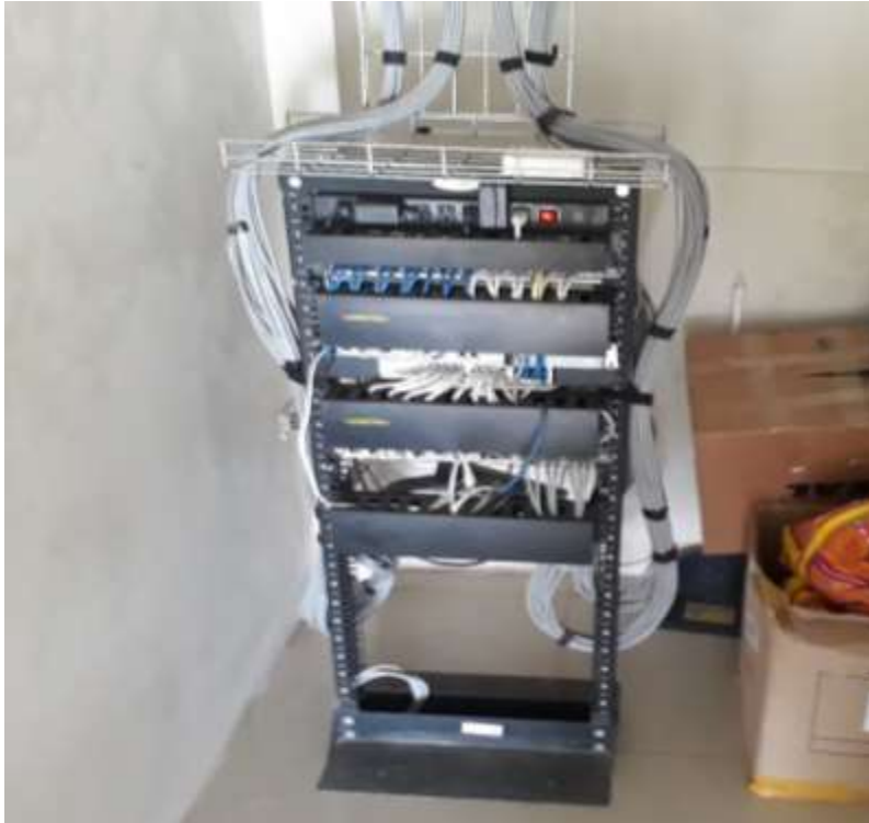
Foto1: Rack de Comunicaciones
