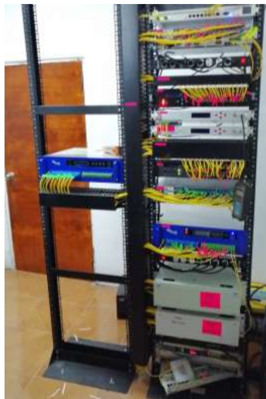
Figura 15: Centro de distribución de internet de la empresa Monvision, parte interna.
