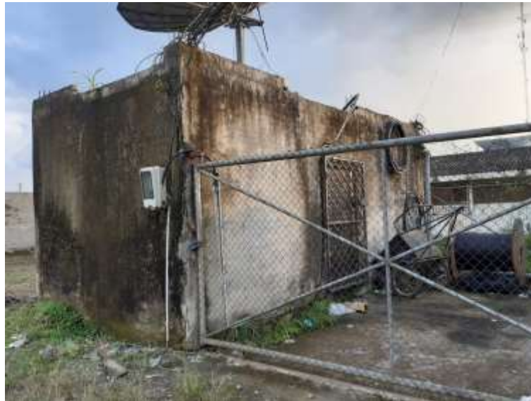
Figura 14: Centro de distribución de internet de la empresa Monvision, parte externa.
