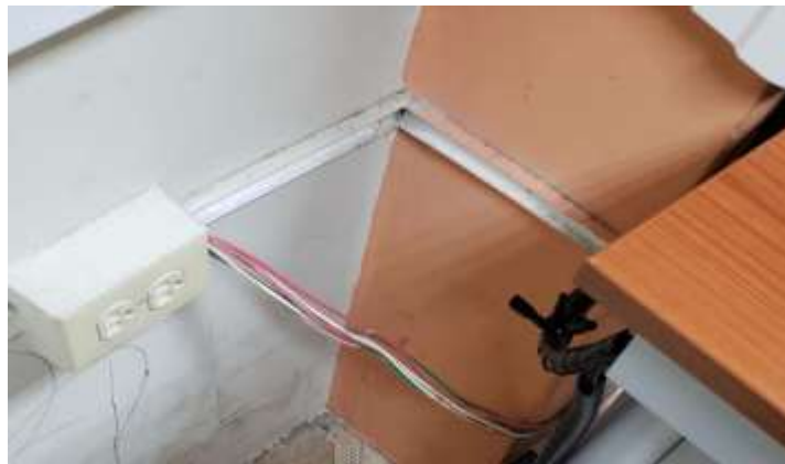
Visualización de Instalaciones eléctricas en mal estado
