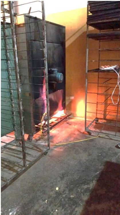
Ilustración 1 Hornos en mal estado Fuente: Fotografía tomada por el autor.
