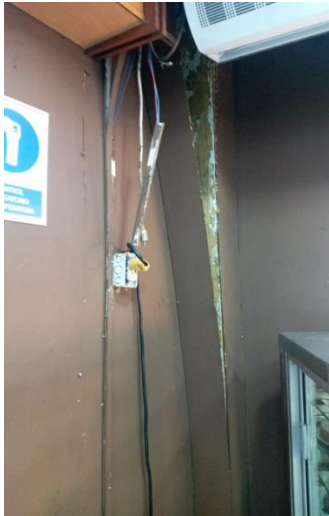
Ilustración 3 Instalaciones eléctricas visibles
