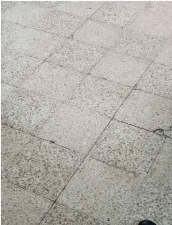
Ilustración 2 Pisos en mal estado
