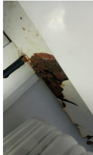
Ilustración 6 Vitrinas en mal estado
