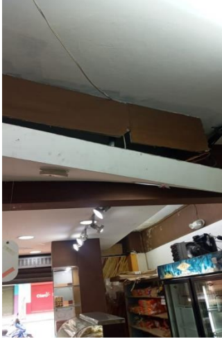
Ilustración 1 Deterioro de tumbado
